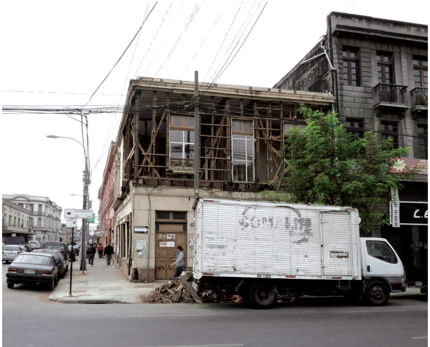
Erdbebenschäden, Typische Holzbaustruktur Chiles
